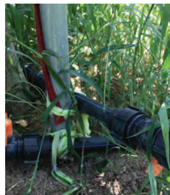
▲ 2016년 복숭아 과수시설현대화지원을 받아 설치한 현대식 관수시설
