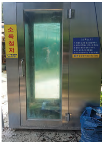
▲ 농장 입구에 설치된 개인 소독시설
